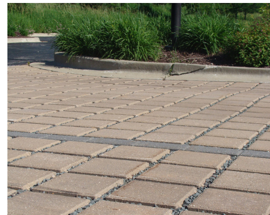
Ejemplo de pavimento permeable
